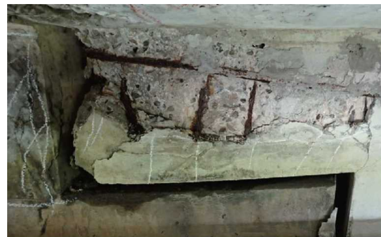
主桁の剥離・鉄筋の露出 (香川県東かがわ市 大川橋)
