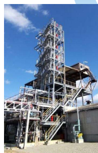
住友化学 (愛媛工場) ケミカルリサイクル実証設備
